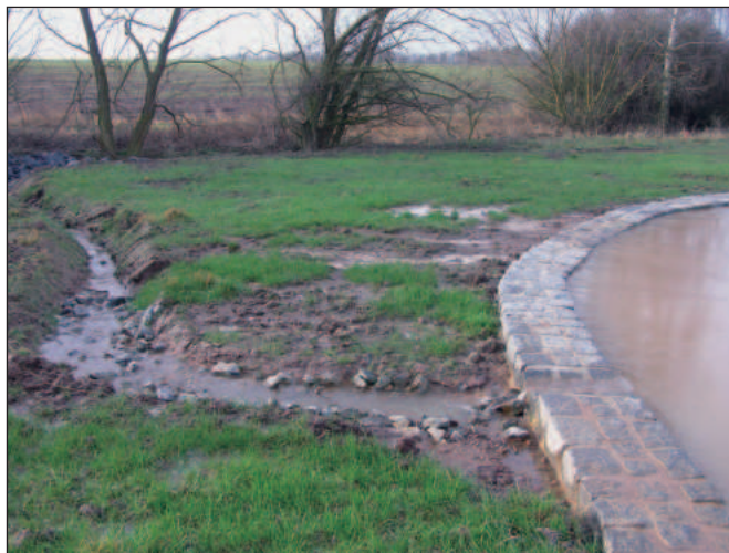
Přepad na zasakovací jámě
